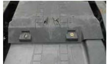
Tampa das baterias em falta, danificada ou partida.
